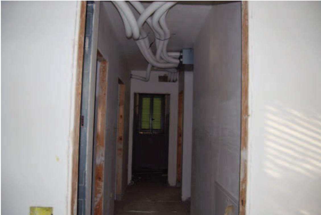
Fotografia C.20 - Condominio Ginestra - Interno appartamenti tubazioni impianto di ventilazione meccanizzata
