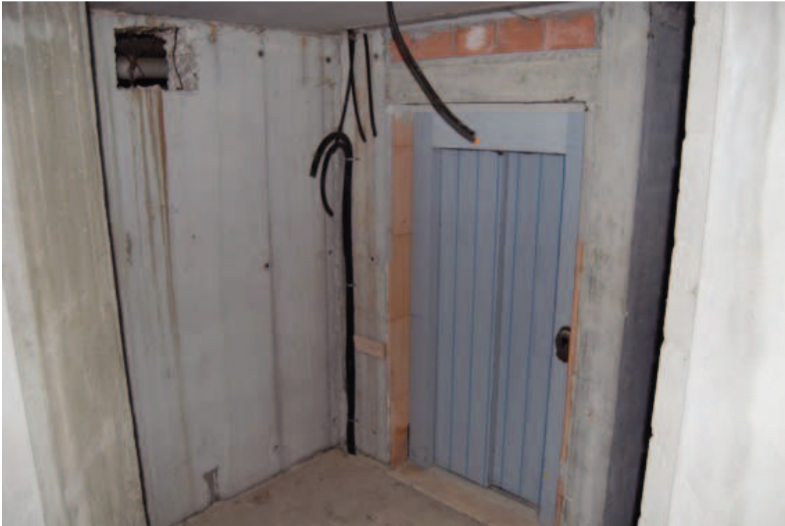
Fotografia C.14 - Condominio Ginestra - Ascensore piano interrato
