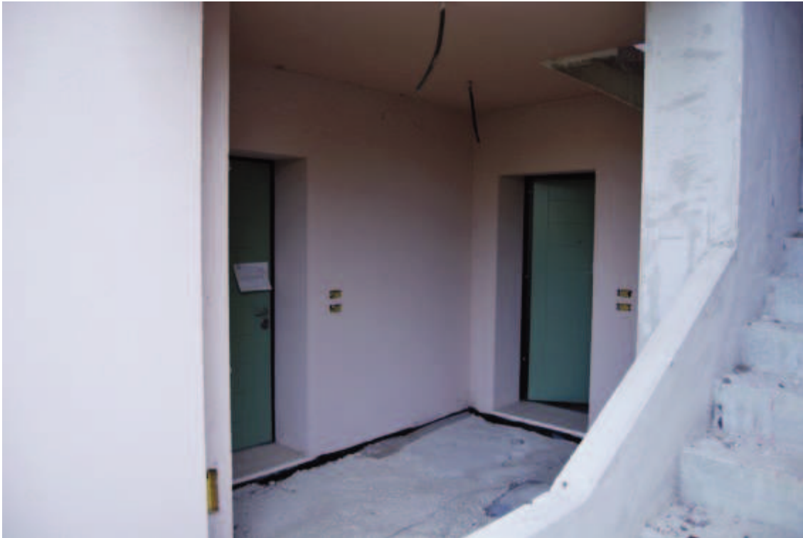
Fotografia C.22 - Condominio Ginestra - Particolari portoncini ingresso
